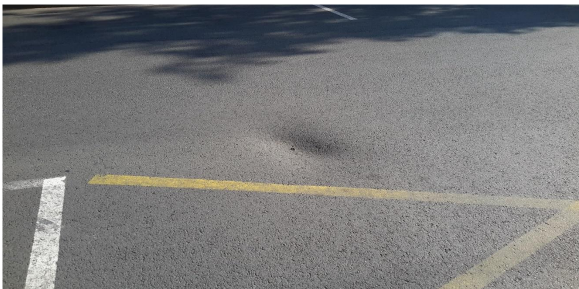
13. attēls. Asfalta iesēdums Stabu ielā iepretim namam Nr.113 (2018. gada 6. septembris).
